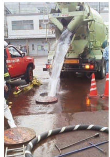
防火水槽への給水
