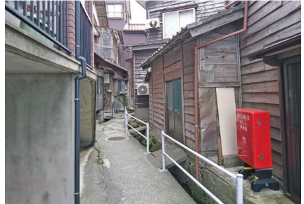
地区の防災上の課題を検証して配備した40ミリホース(能生小泊地区)
