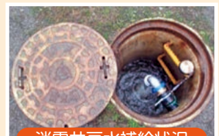
消雪井戸水補給状況
